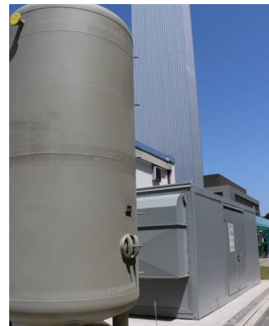
Blockheizkraftwerk am Marquardt Stammsitz
